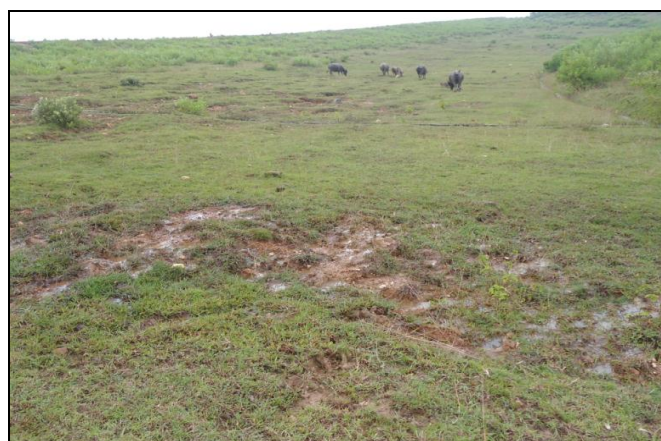
Hình 1. Nước thấm ra mái hạ lưu – Vị trí lòng sông (lân cận mặt cắt C5)
