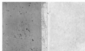
Hình 3. Bề mặt bê tông đúc và không đúc với vải hỗ trợ ván khuôn
