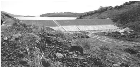
Hình 1. Đập tràn sự cố hồ Yên Lập
