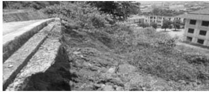
Hình 1. Sạt lở tại vị trí sau nhà HĐND
